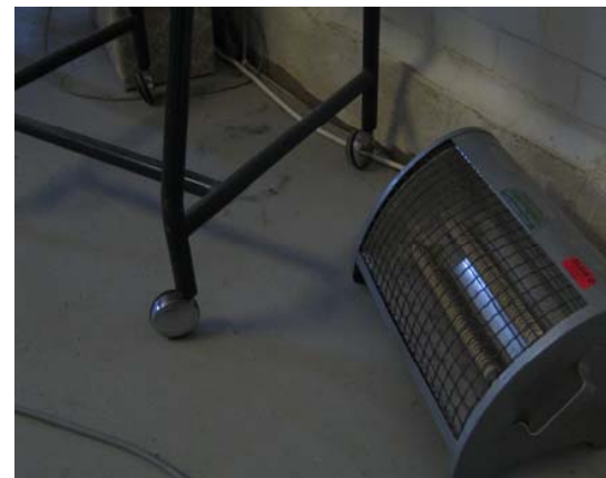
Bild 45. Gasdriven fläkt för att värma lokalen.
